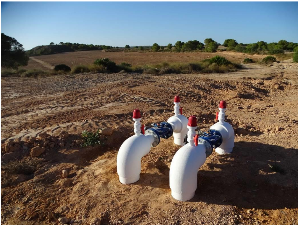
Imagen 17. Detalle del nuevo sistema de riego instalado, junto a la carretera que hace de límite sur de la ZEPA. Al fondo nuevas plantaciones de cítricos. Fuente: P.García/ANSE
